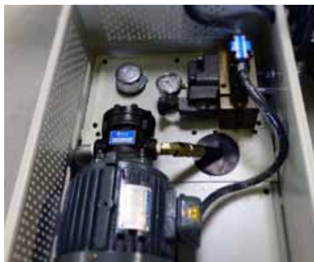
Freistehendes externes Hydraulikaggregat.
