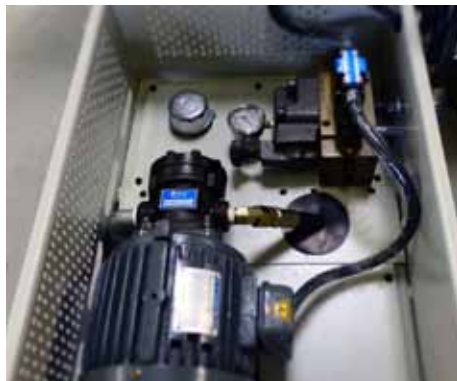
Freistehendes externes Hydraulikaggregat.
